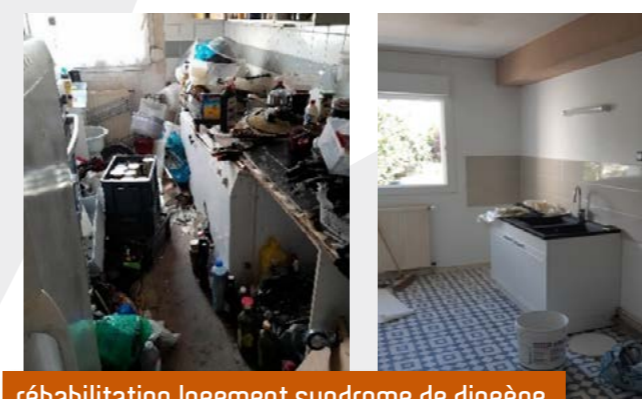
réhabilitation logement syndrome de diogène
